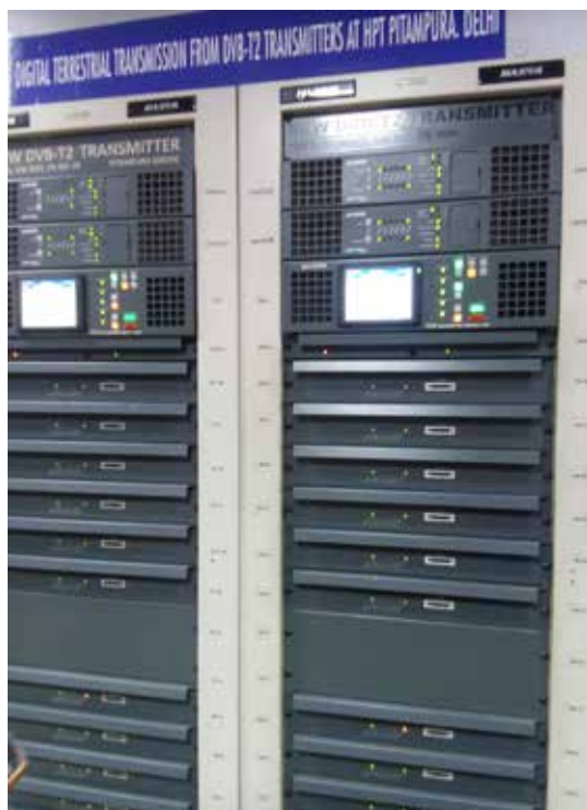
6.0kW DVB-T2 Transmitter
