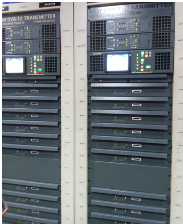
6.0kW DVB-T2 Transmitter
