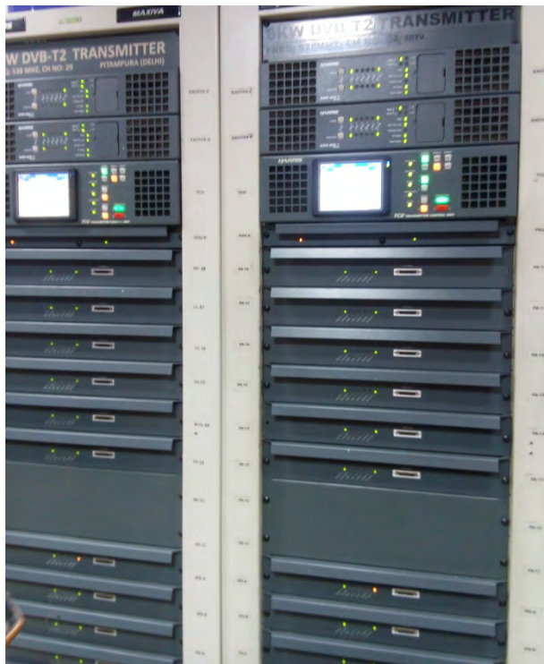
6.0kW DVB-T2 Transmitter
